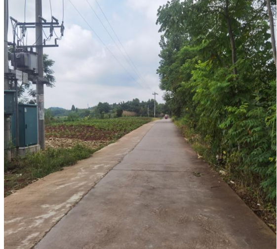
水库周边穿越保护区公路缺失防撞护栏
