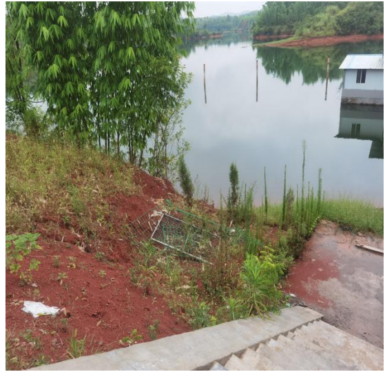
隔离网损毁、标示标牌遗失
